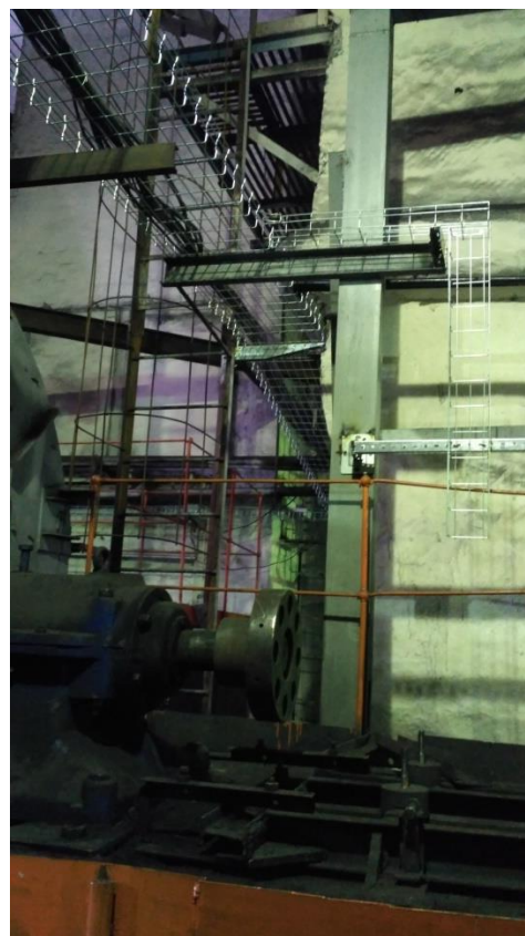
Кабельные лотки ДС, ДВ Котла №4 КЕ 25-14
