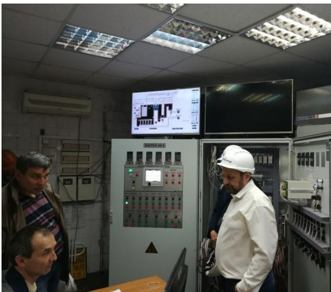
Шкафы управления котлами КВТС-30 (САУ КВТС) в комплекте м АРМ
