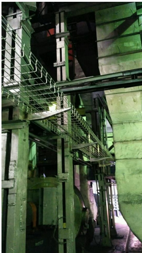
Кабельные лотки ДС, ДВ Котла №2 КВТС-30
