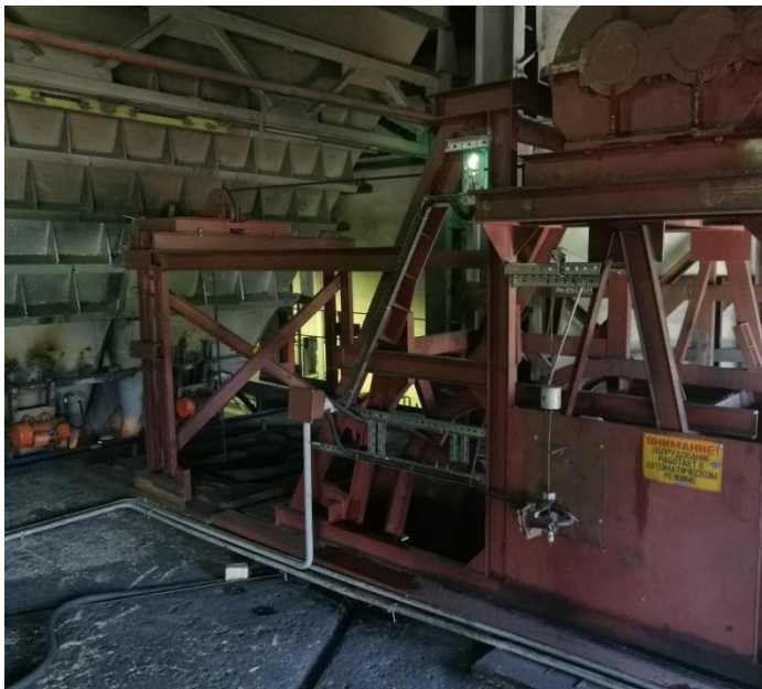
Подъемник скреперный ПСКМ-0,35-75 котла №1
